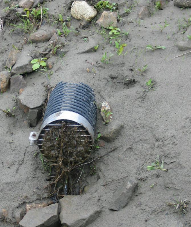
Photo 3 : Grille partiellement obstruée Source : Mikael Guillou (MAPAQ)
